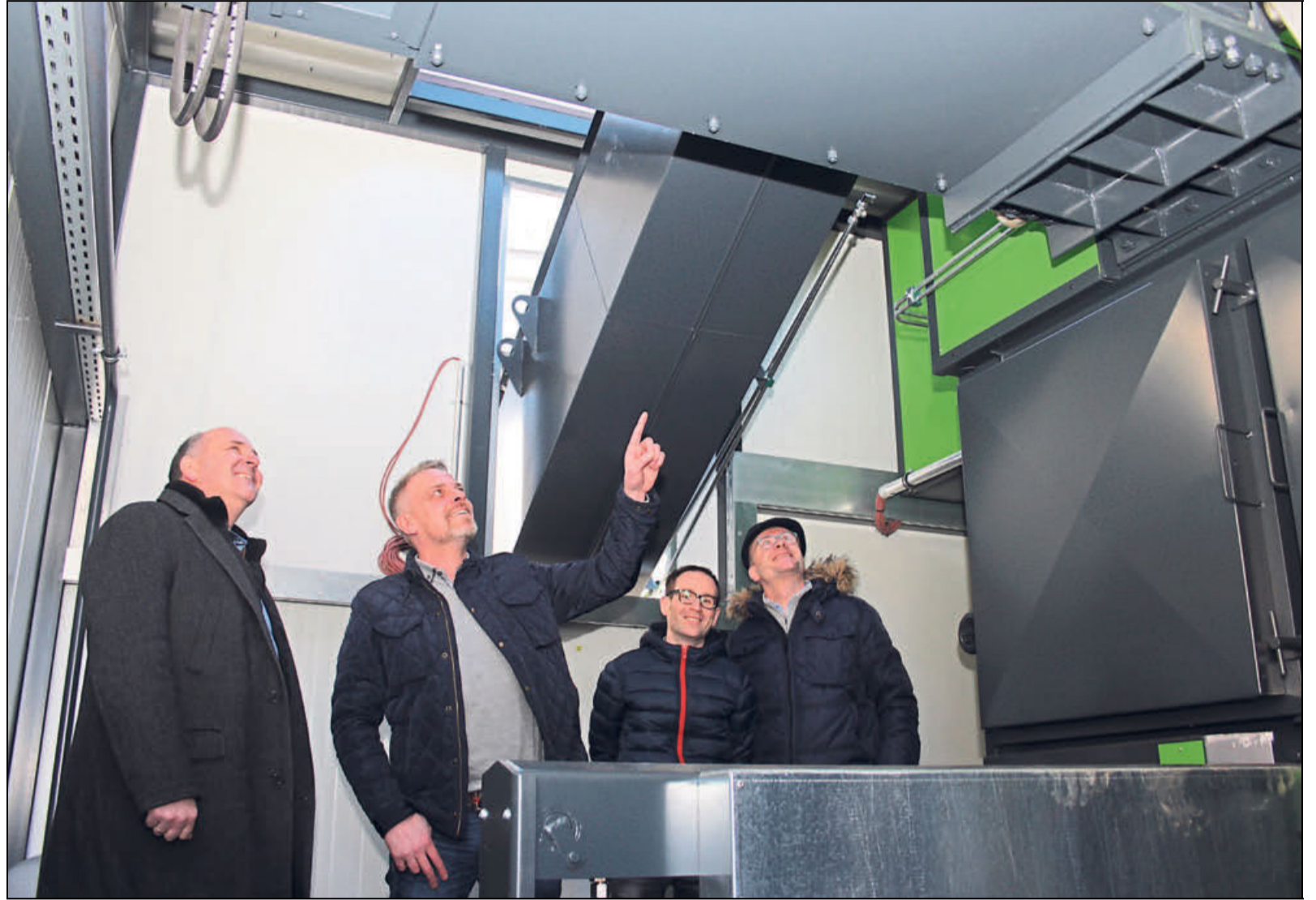
Lars Pollmeier (2. von links) erklärt im Inneren des Heizcontainers Bürgermeister Hubert Erichlandwehr, Florian Ostermann (Energie-
