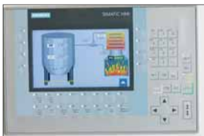
Steuerdisplay der neuen Anlage
