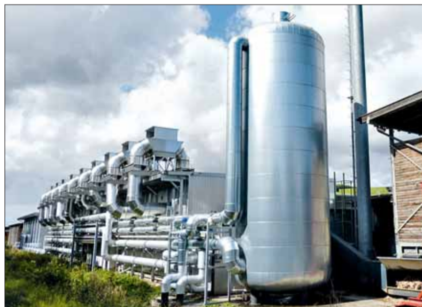
100 000 l-Pufferspeicher und Verrohrung der Trockner. Auf deren Dach sind die Wärmerückgewinnungssysteme zu erkennen.
