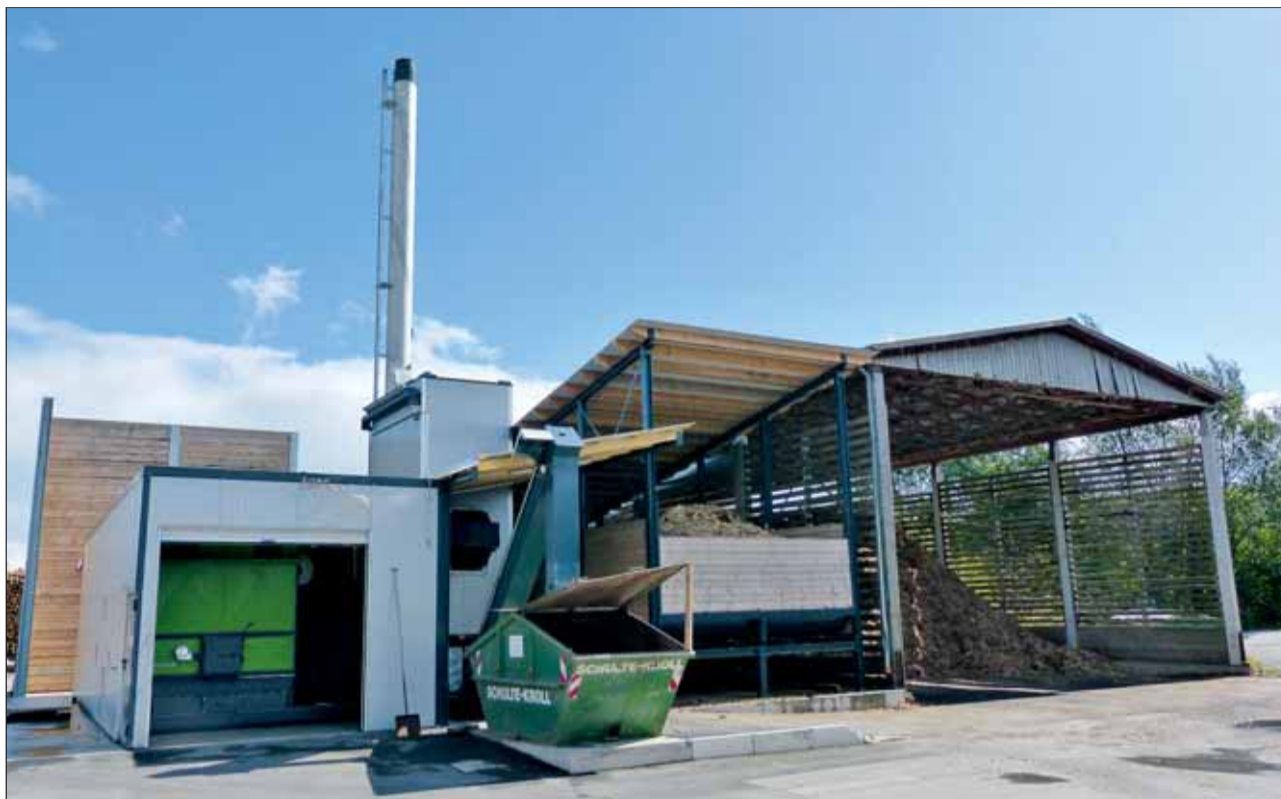
Die in diesem Jahr installierte Heizanlage auf einen Blick: der Kessel und die Steuerung befindet sich im Container (links). Um diesen möglichst kompakt zu bauen, gleichzeitig aber hohe Wartungsfreundlichkeit zu garantieren, befinden sich an den entscheidenden Stellen in den Containerwänden Revisionsöffnungen. Zwischen Kessel und Bunker ist der Filter zu sehen, dahinter der Kamin. Der Brennstoff wird unter einem Dach gelagert (rechts). Fotos: Ißleib
