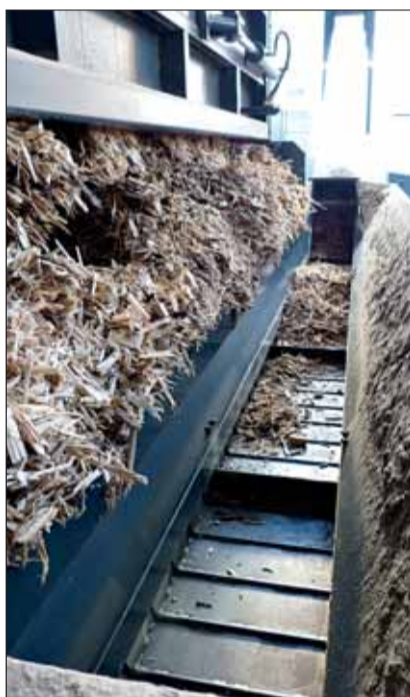
Den Transport vom Bunker zum Stoker übernimmt ein Plattenförderer.
