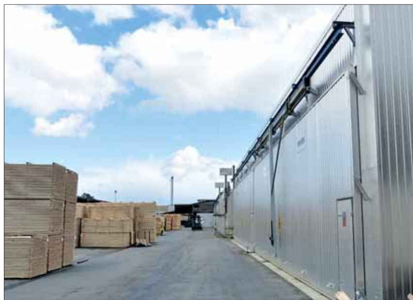
Mit den hinzugekommenen Kammern (Vordergrund rechts) wurde es deutlich, dass die Wärmeversorgung durch den die eine vorhandene Heizanlage (am Ende der Reihe) nicht mehr ausreicht. Daher wurde eine zweite, leistungsgleiche, Anlage von Polzenith in diesem Jahr in Betrieb genommen (in der Mitte des Bildes ist deren Kamin zu erkennen).
