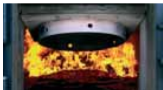
Heizkessel Die Feuerung
